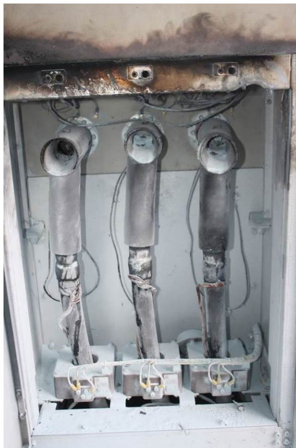
Slika 5. Bliži snimak oštećenja na priključcima u ormaru
