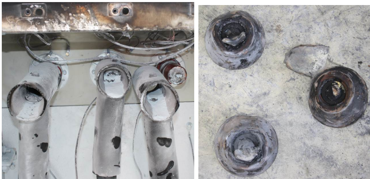
Slika 8. i 9. Bliži snimak oštećenih dijelova na priključcima
