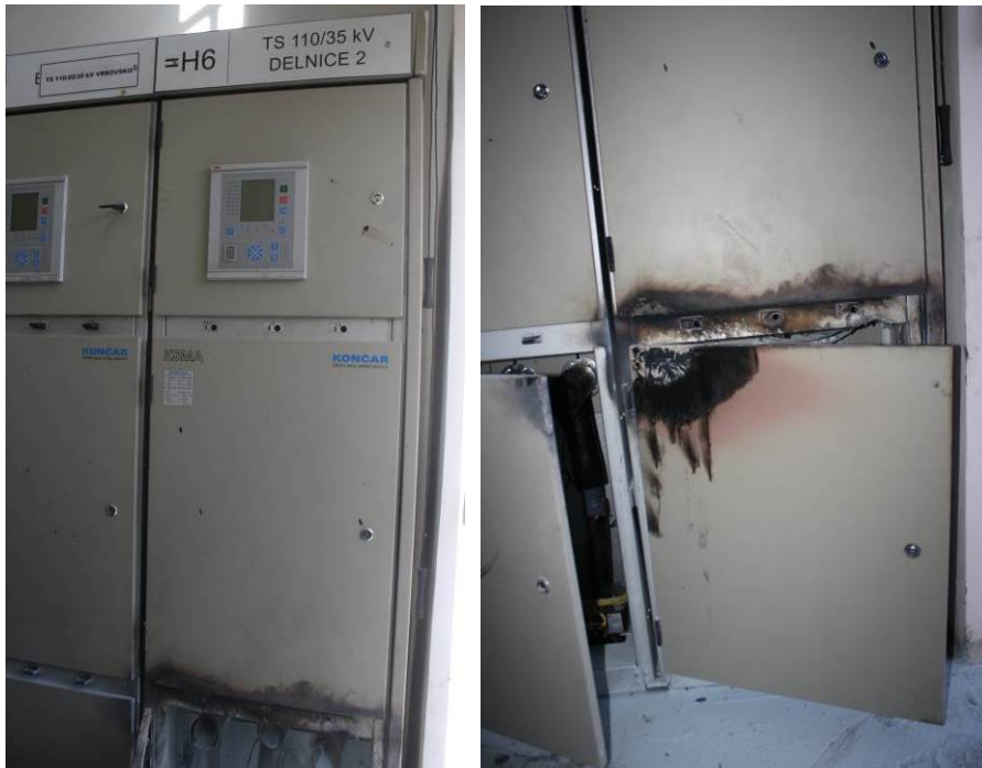
Slika 3. i 4. Oštećenja na vratima ormara vodnog polja H6
