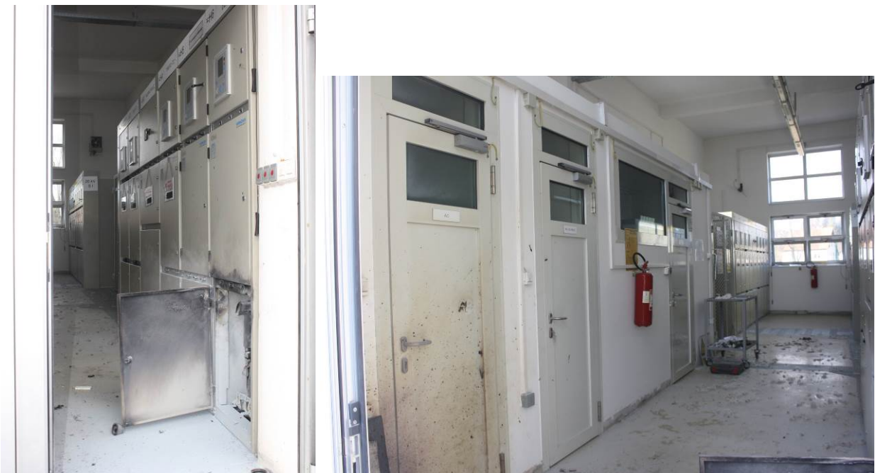
Slika 1. i 2. Oštećenja na ulaznom dijelu u trafostanicu
