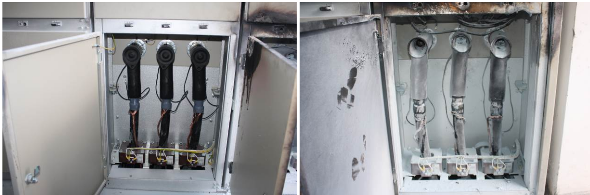
Slika 6. i 7. Usporedni snimak neoštećenih priključaka i oštećenja na priključcima u ormaru
